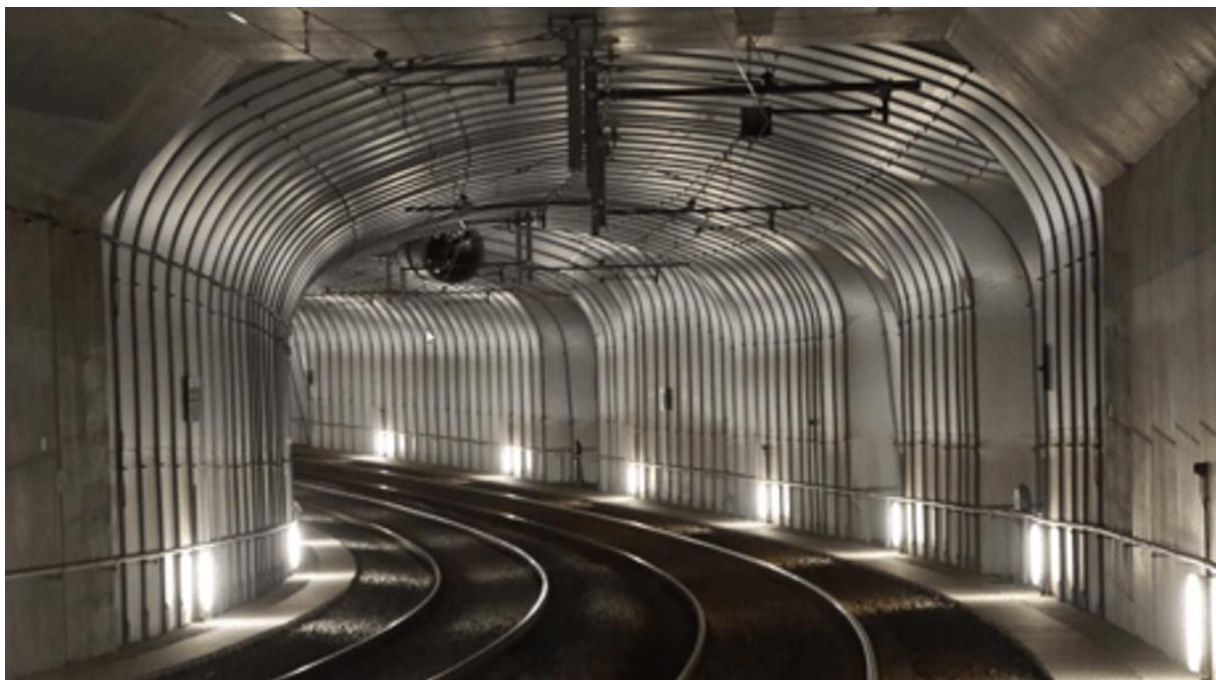
Foto: Bruk av signal So3 Tunnellys påsatt
