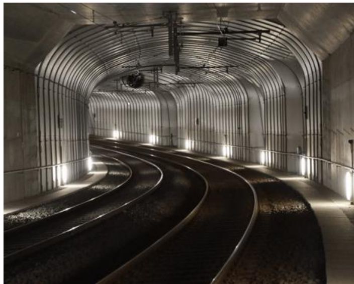
Figur 8 Bildet viser lyset påslått i tunnel (signal So3)
